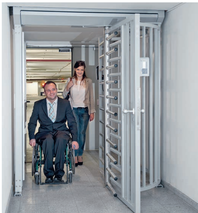
01 Tornello con porta girevole integrata per accesso a garage sotterraneo
